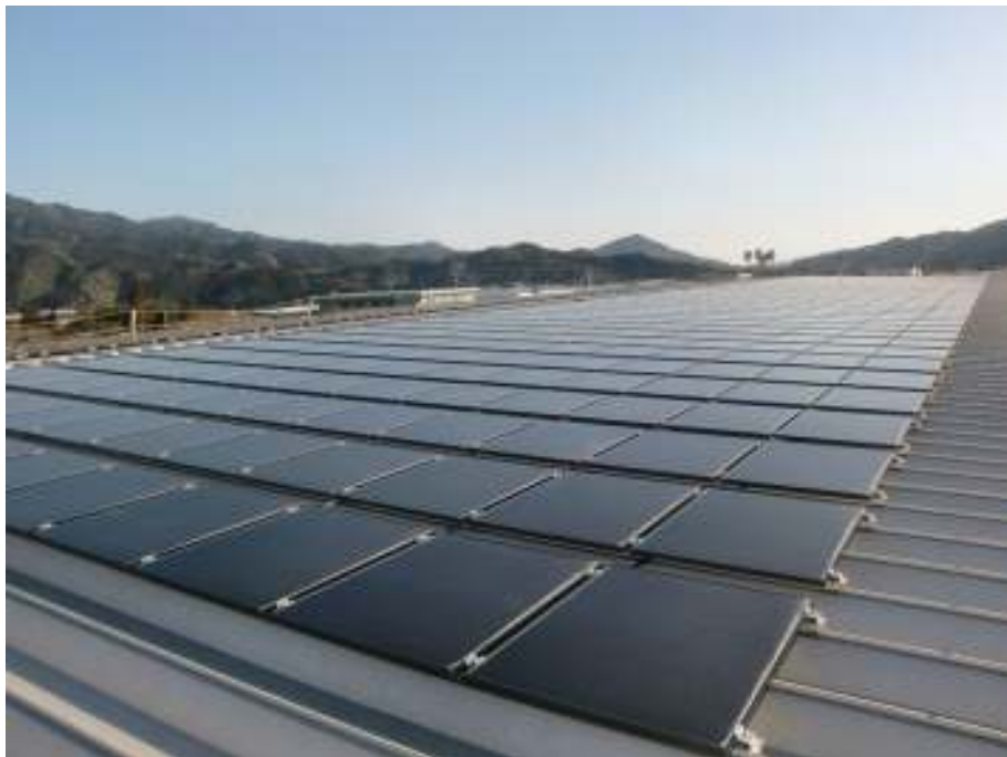
第5工場屋根:太陽光発電パネル
